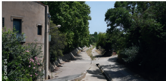
État existant de lit bétonné en milieu urbain.
